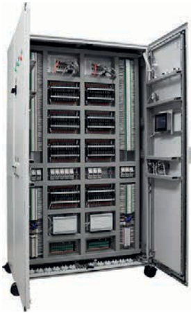
Устройство противоаварийной автоматики энергоузла УПАЭ
